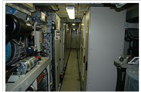
Maschinenraum einer 185.1 der DB AG
